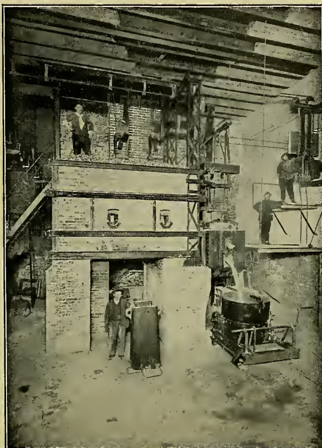
Usine de Livet. — Haut-fourneau électrique (système Keller).
